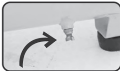
Fig. 7 – Válvula de descarga
